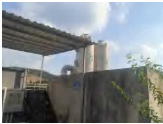
污水处理站-缺氧池+生物脱氮塔
