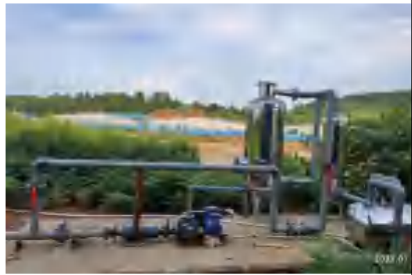
脱硫罐、水封罐、稳压系统
