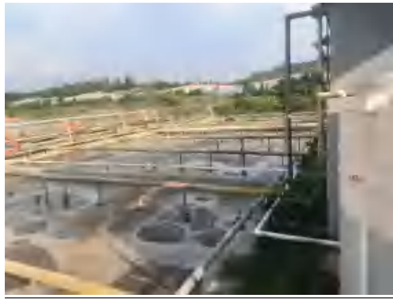
污水处理站-好氧池
