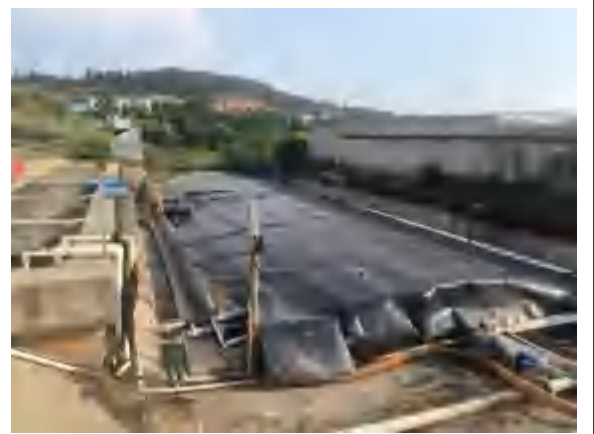
污水处理站-集污池+配水池
